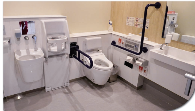
エントランスロビーの売店前にあるバリアフリートイレ。オストメイト用設備とおむつ替えシートも設置されている。<助成対象施設>
