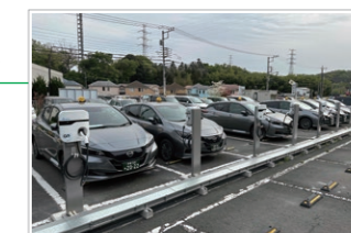
EV車の充電設備
