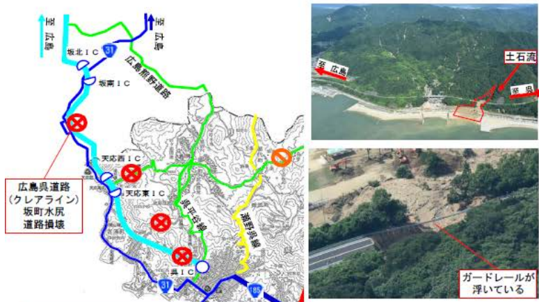
(1) 広島呉道路(クレアライン) 坂町水尻 道路損壊
