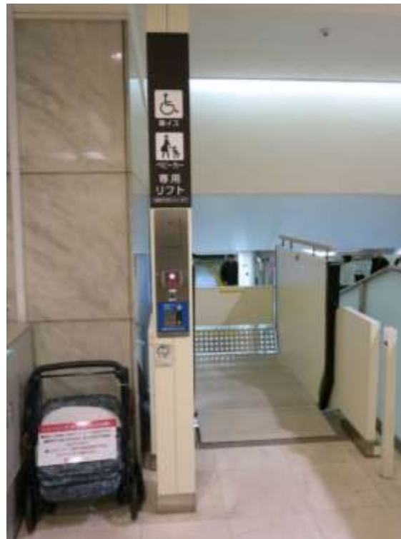
図 階段昇降機の利用案内（上段側） （商業施設）
