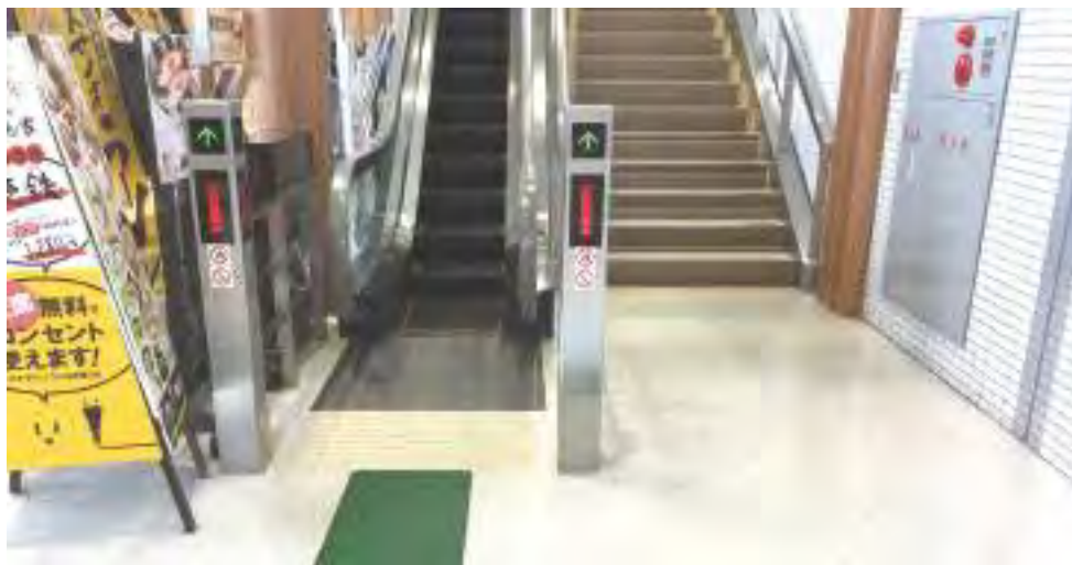
誘導用ブロック(誘導用マット)が階段には敷設されずにエスカレーターの上に敷設
