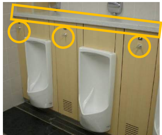
小便器の横に設置される例
