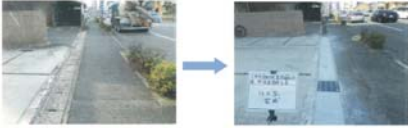
②歩道部の横断勾配により、ハンドルをとられる。
