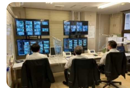
遠隔監視システム(西日本鉄道)
