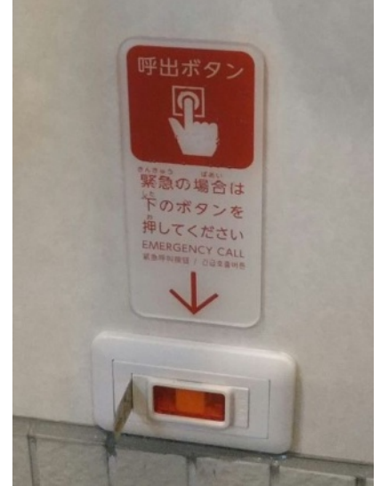
⑦ 緊急通報ボタンは押しボタンのみである。(船全体がそう)
