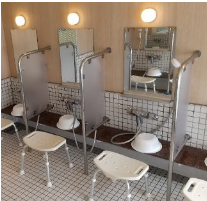
① 脱衣室や浴室、シャワーブース内には手すりがないため、車椅子使用者の入場が難しい
