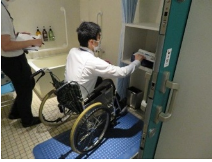
⑤ 脱衣スペースに手すりがない
