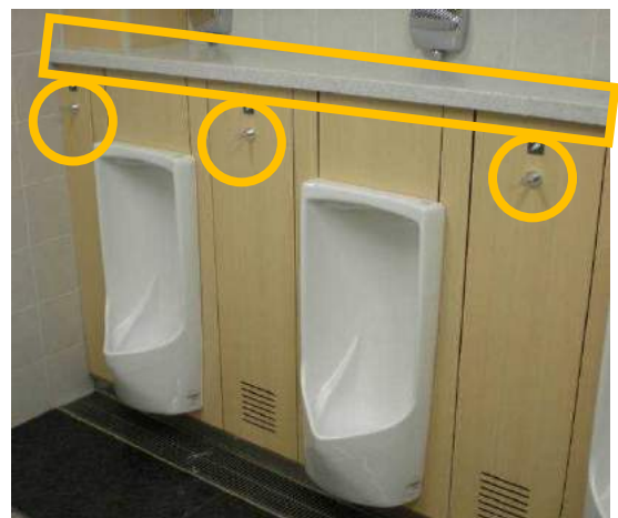
小便器の横に設置される例
