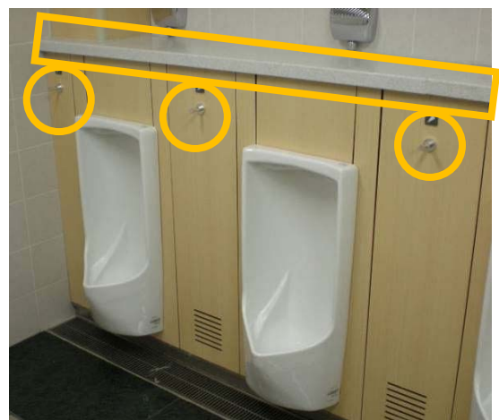
小便器の横に設置される例
