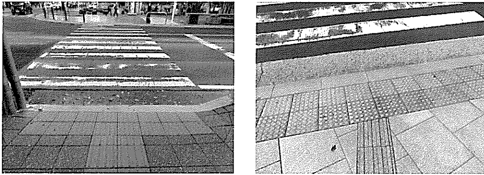
図-2 縁石と点状ブロックとの離隔がないケース
