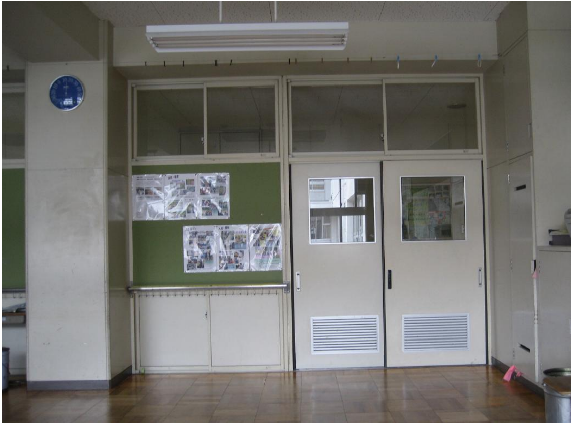
写真 1 教室取付位置
