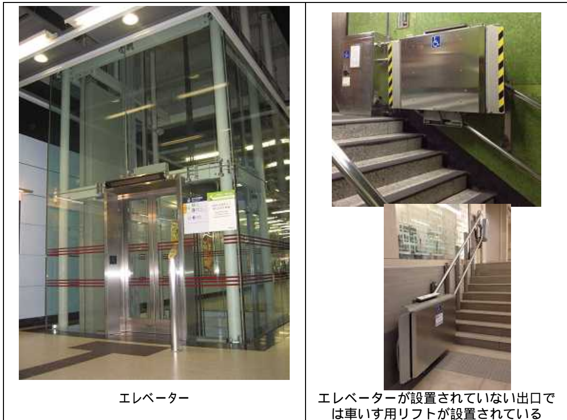
図 3-18 エレベーター、階段の車いす用リフト
