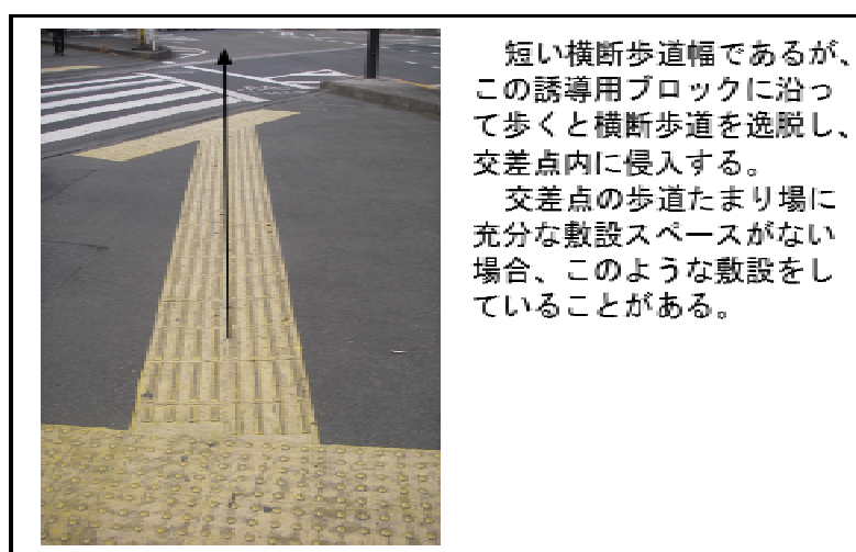
写真2.6 誤った誘導用ブロックの敷設例
